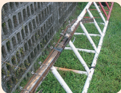
●漆色斑斕、鏽蝕嚴重的舊鐵塔，原本靠綁著鋼條紮牢穩固，非常克難。
